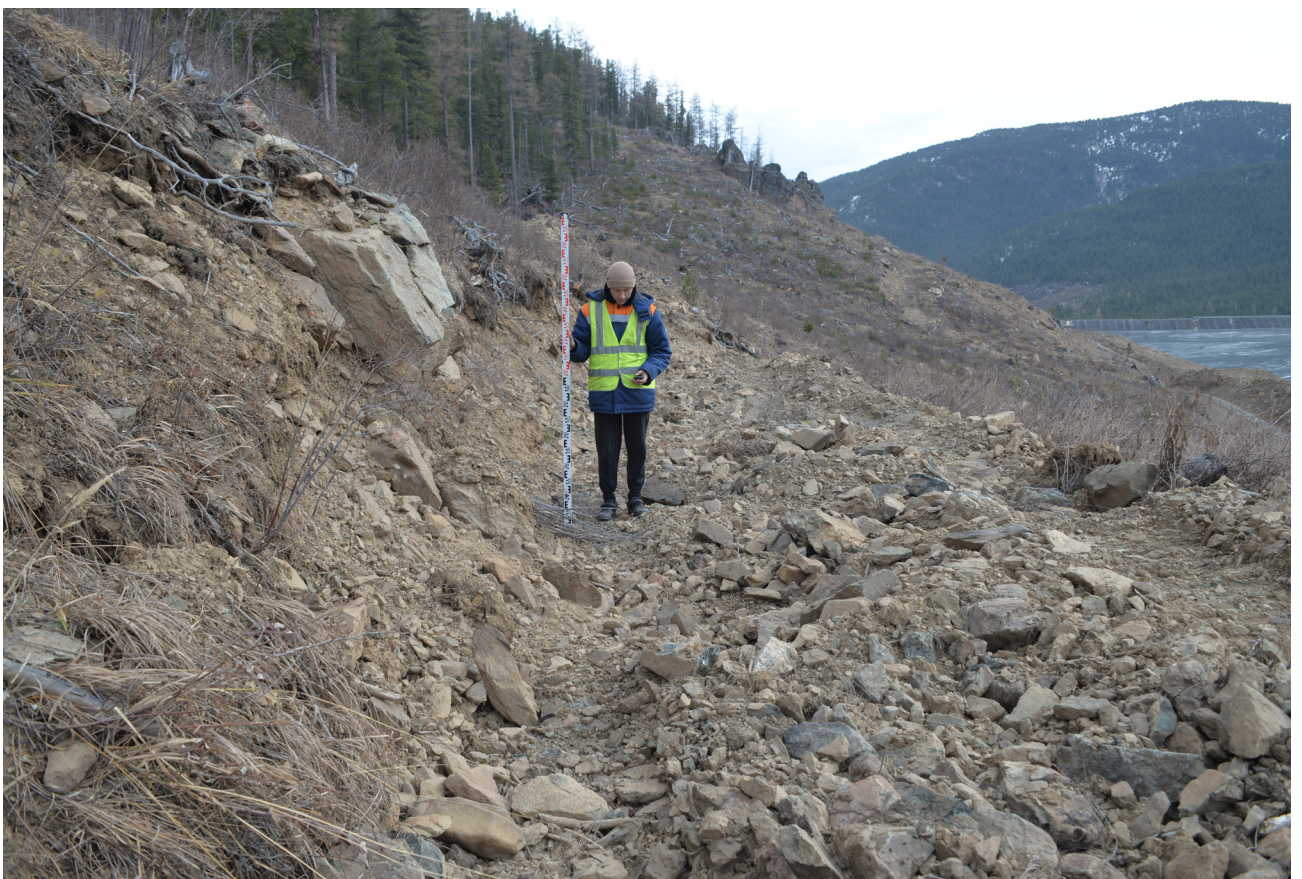
Рис. 29. Увеличение высоты дамбы. Северный участок. Деталь №3. Техногенное разрушение горного склона. Вид с запада.
