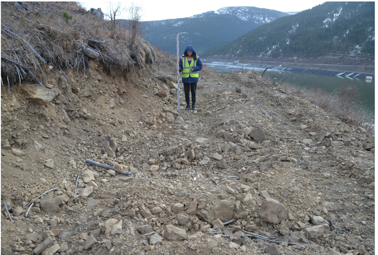
Рис. 28. Увеличение высоты дамбы. Северный участок. Деталь №2. Техногенное разрушение горного склона. Вид с ЗСЗ.
