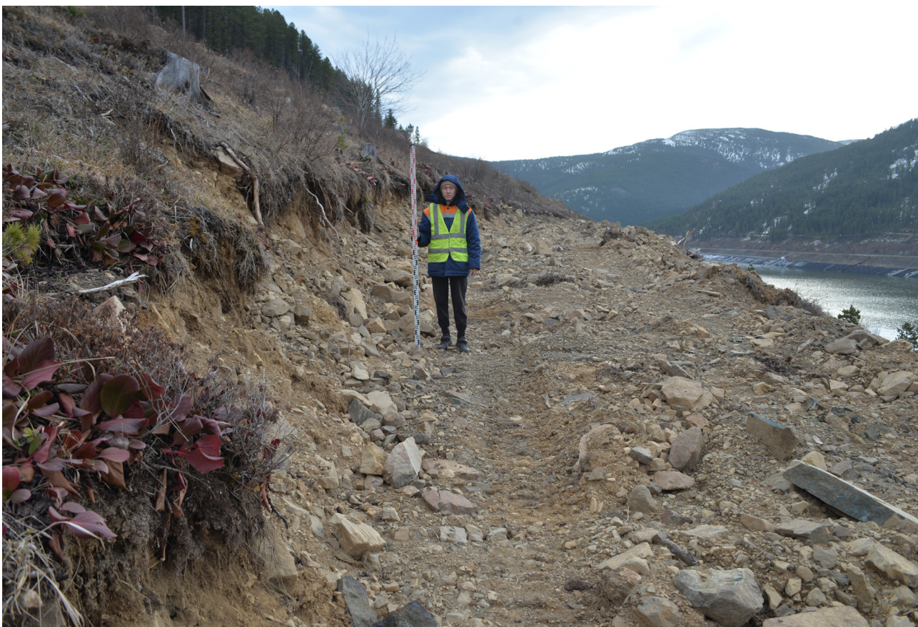
Рис. 27. Увеличение высоты дамбы. Северный участок. Деталь №1. Техногенное разрушение горного склона. Вид с ЗСЗ.
